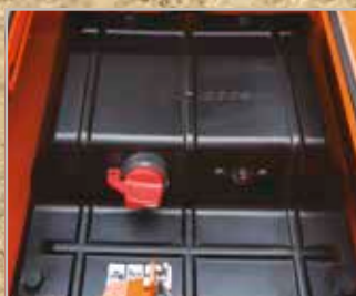
Interruptor de corte de la batería
